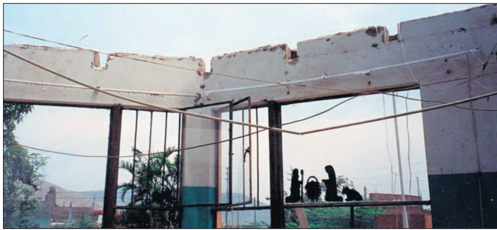
So sah das Objekt aus, das dank des beherzten Einsatzes zu einem Behindertenzentrum ausgebaut wurde. Auch die kleine Krippenszene in der rechten Fensteröffnung konnte über die Trostlosigkeit nicht hinwegtäuschen, die sich jedoch verflüchtigte, ...
